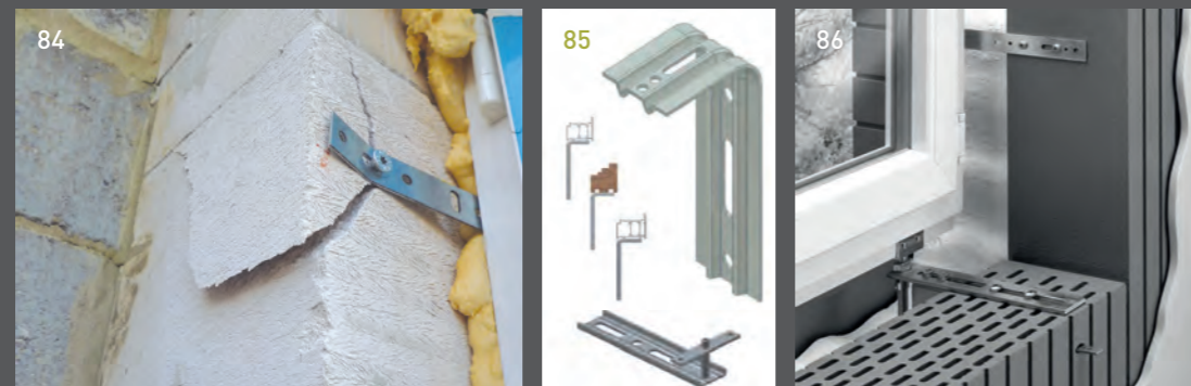
↑ 84 Beschadiging van de binnenmuur door slecht bevestigde bevestigingsbeugel. ↑ 85 Steunprofielen voor ramen en deuren. ↑ 86 Bevestigingsprofielen voor ramen.
