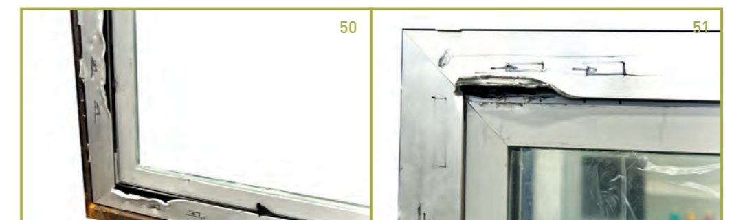
† 50 en † 51 Beschadigde raamprofielen na een test op inbraakweerstand.
