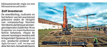
De bouwwerken van de eerste fase met zestien huizen en zestig woningen zijn intussen gestart. Foto's Klaas De Scheider
