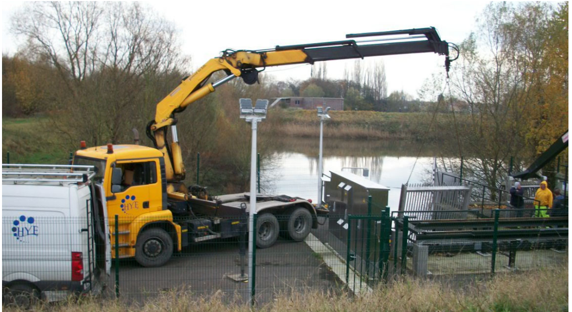
Figuur 24: Pompgemaal Benedenvliet
